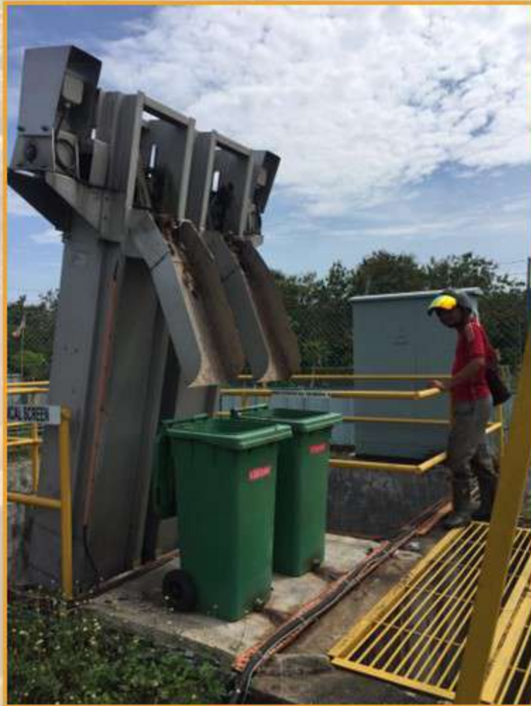
Stesen Pam Penghubung, 6,500 PE
